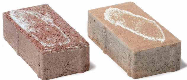
Dlažba s výkvětem
