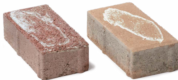
Dlažba s výkvětem
