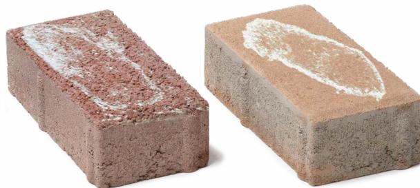
Dlažba s výkvětem
