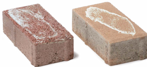
Dlažba s výkvětem
