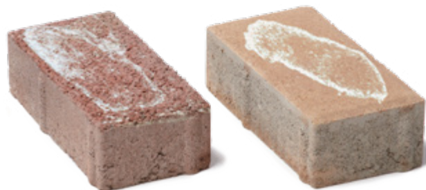
Dlažba s výkvětem
