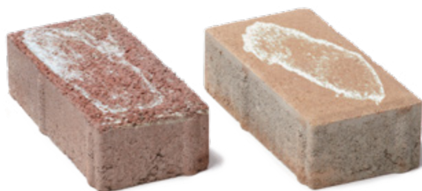
Dlažba s výkvětem
